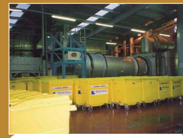
Usine d'incinération de déchets médicaux Incineration plant for medical waste
